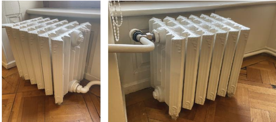
Abb. 31: Radiatoren Kunsthhaus Biel
